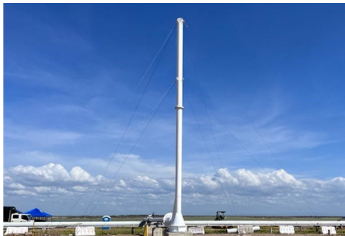
Vent Stack - Hocol 2023
