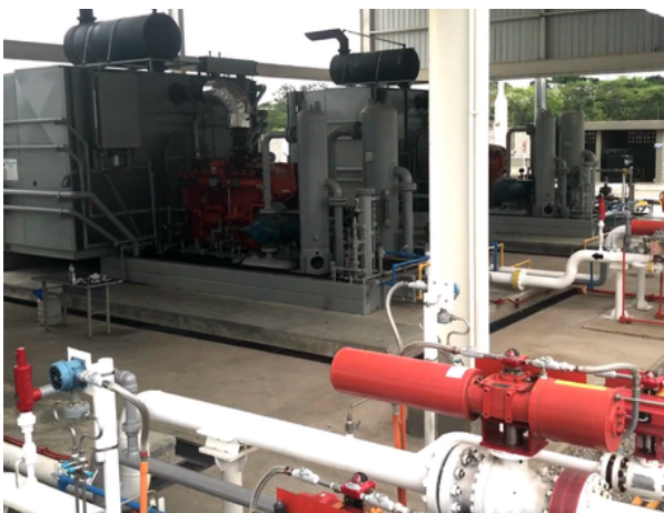
Sistema de compresión de gas, Gases del Caribe, Estación compresora La Paz - 2016
