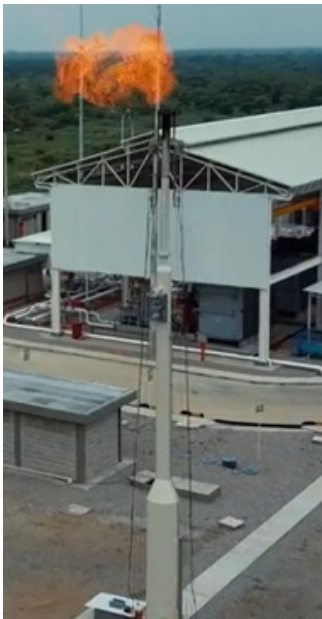
TEA Estación compresora de gas 2016
