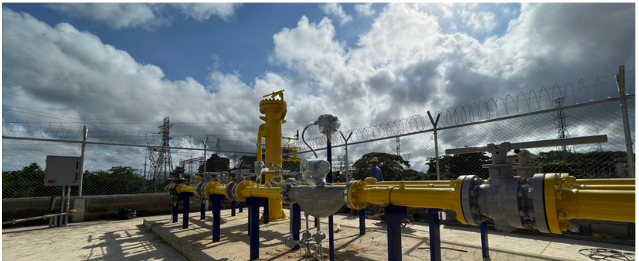
Patín estación de regulación y medición - Termocaribe 2023
