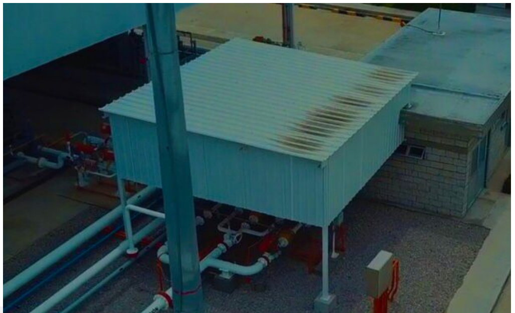
Sistema de medición con medidor rotatorio, Gases del Caribe, Estación compresora La Paz - 2016
